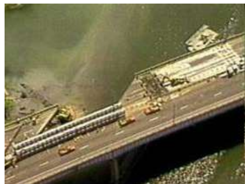
写-2 マイアナス橋の落橋
