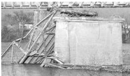
写-1 シルバー橋の落橋
